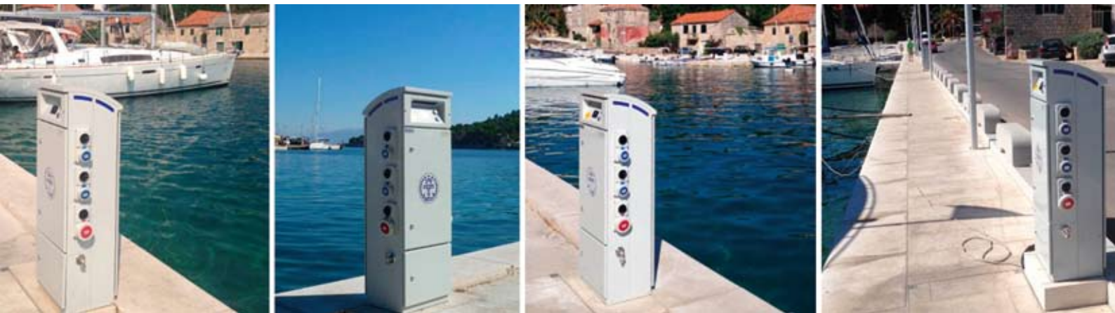
Slika 13. Priključni ormarići u luci Rogač na otoku Šolti
