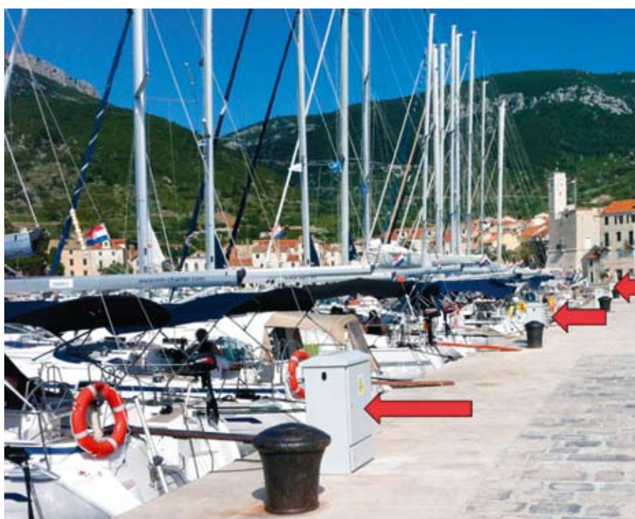
Slika 7. Priključni ormarići za nautičare u Luci Komiza
