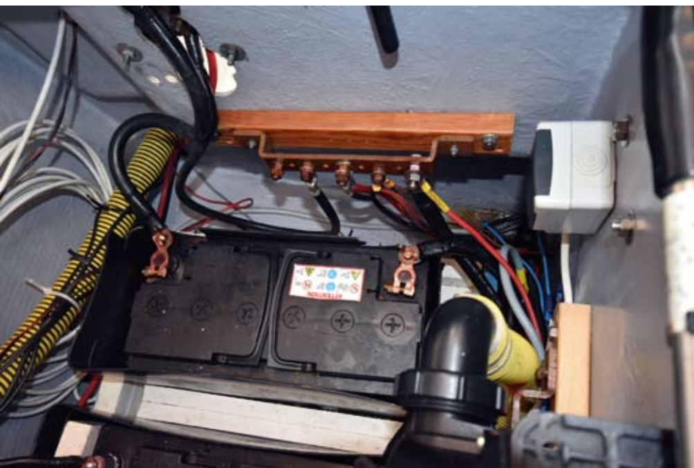
Kvalitetna sabirnica i čvrsti spojevi ključni su elementi električnih instalacija na brodu
