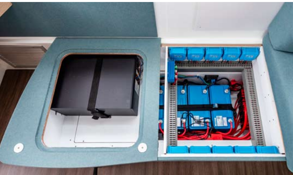
LFP baterije i oprema za nadzor na katamaranu Fountaine Pajot Helia
