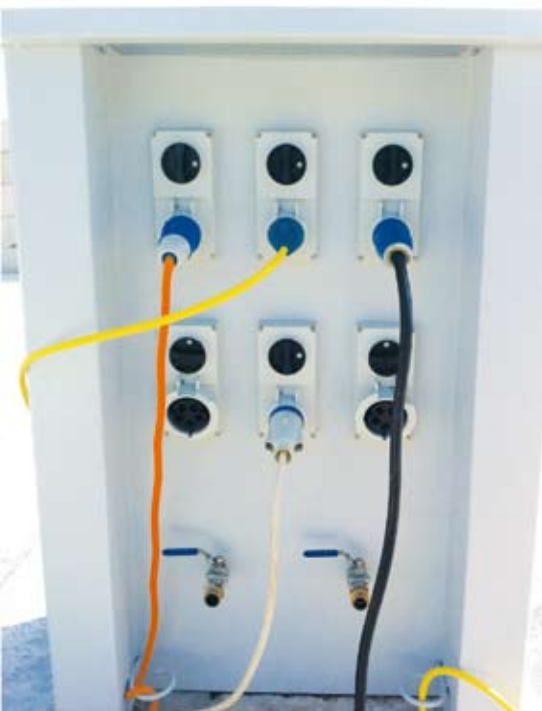
Priključni ormarić Schrack Technik u Komiži na otoku Visu
