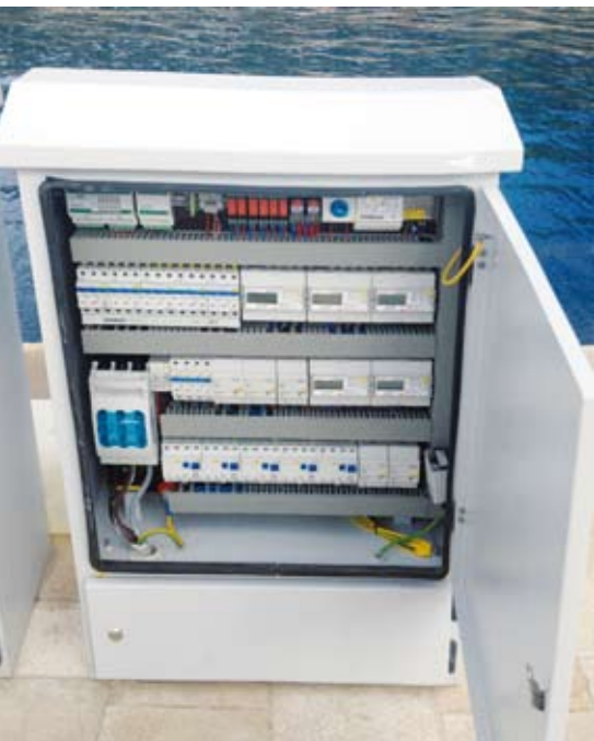
Pregled ormarića sa zadnje strane. Vide se ugrađene zaštitne sklopke i osigurači za svaku utičnicu posebno kao i brojila opet posebno za svaku utičnicu
