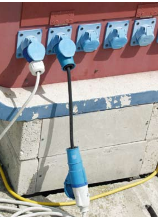
Utičnice na priključnim ormarićima nisu jednake u svim marinama pa ponekad treba imati i kratki kabel za adaptaciju
