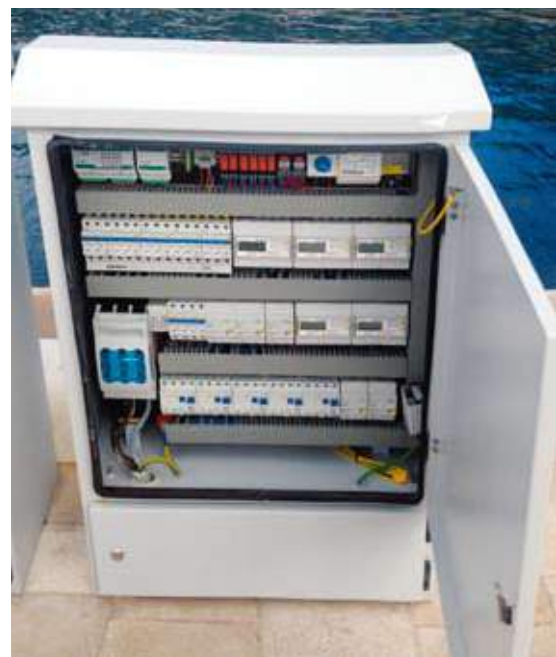
Zadnja strana Schrackovog priključnog ormarića nevidljiva za korisnika, sa svim zaštitnim sklopkama
