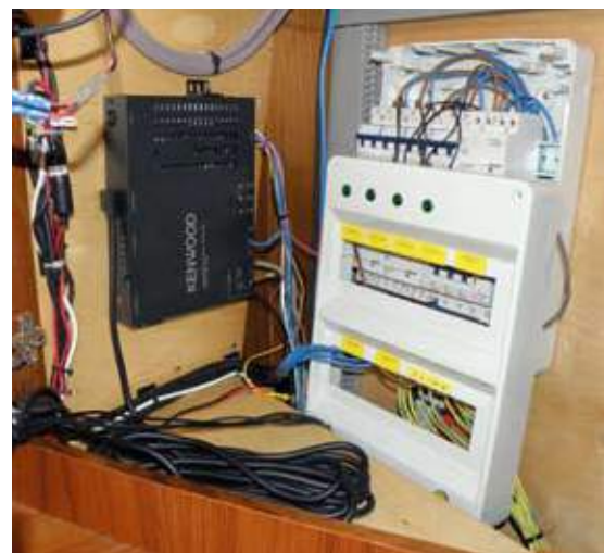
I na brodu razvod za 220 V mora biti odvojen od 12 ili 24 voltne instalacije
